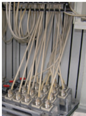
Bild 3.8.2 – Sandbefüllung der NH-Sicherungseinsätze
